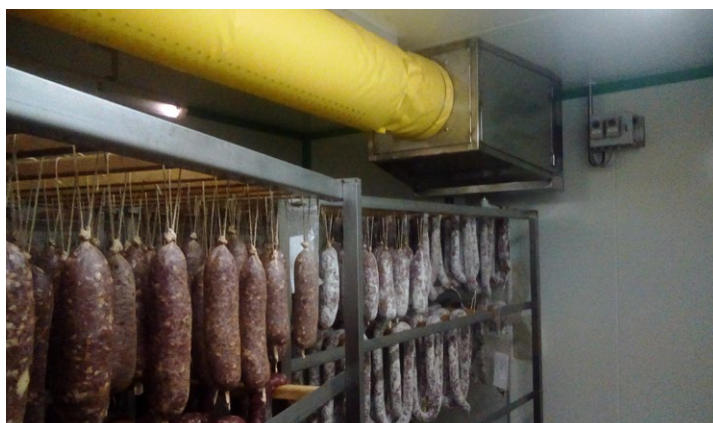
Séchoir fermier avec gaine de répartition
